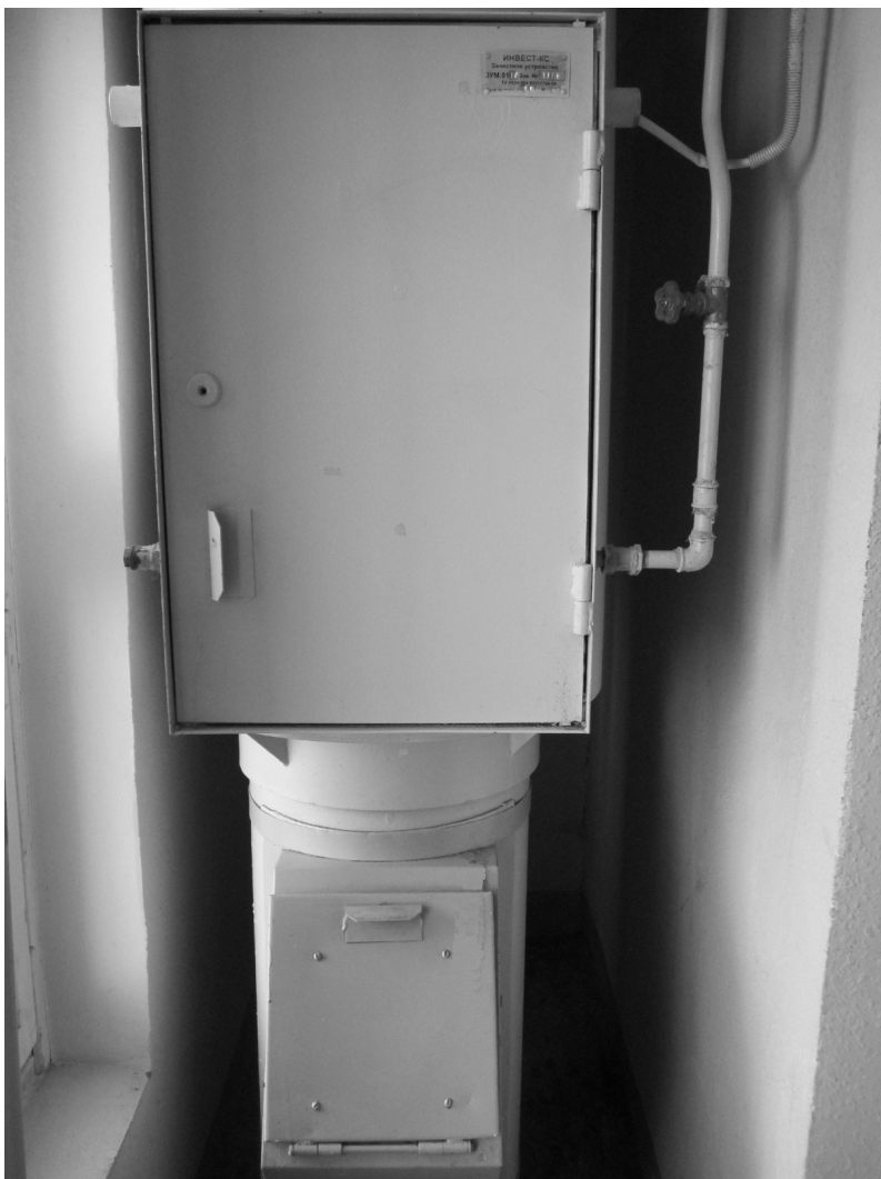
Рис. 12. Шкафчик с очистным устройством на стволе мусоропровода
