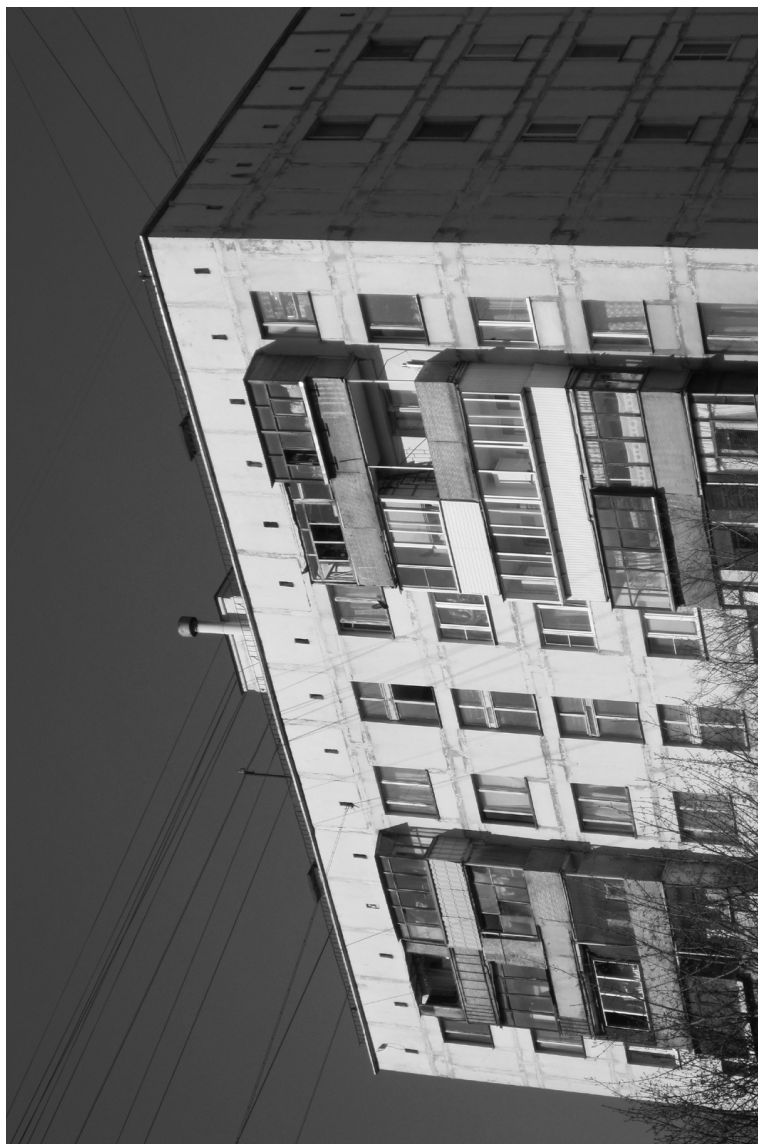
Рис. 11. Вентиляционный ствол мусоропровода с дефлектором на крыше здания
