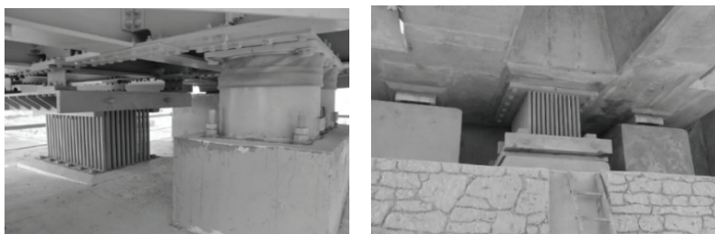
Рис. 2. Сейсмозащитные устройства на мосту через р. Иле в Казахстане. Амортизатор стержневой на объекте 16
