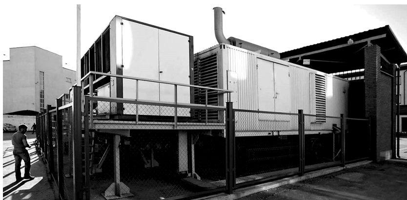
Рис. 3. ДГУ на мобильной платформе у ЦОД Москва-1 на Остаповском проезде в Москве
